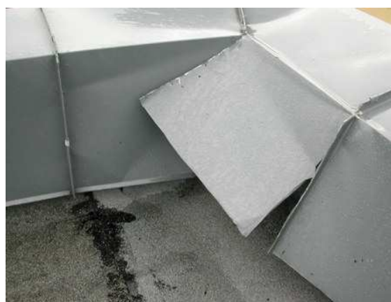
Bilde 2: Taklekkasje Steigentunet
